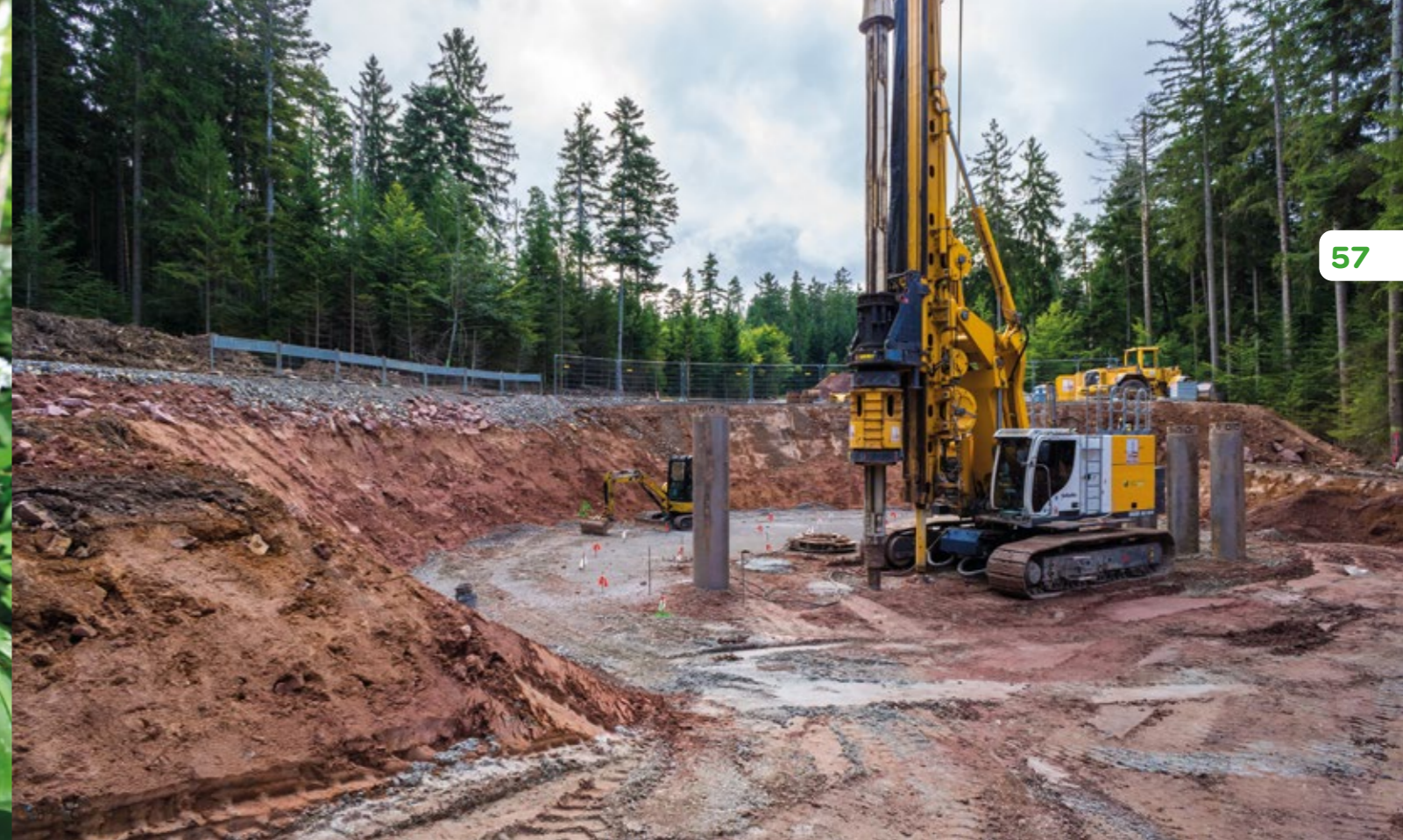
Gewaltige Beton-Fundamente, rund 15 m tief, müssen für diese Anlagen in die Erde getrieben werden
