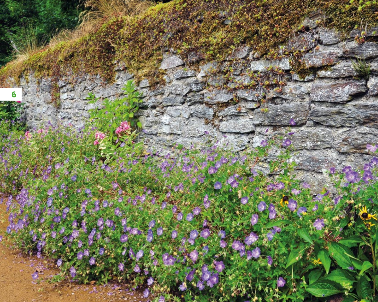
Alte, fugenreiche Kirchenmauer mit Blühsaum
